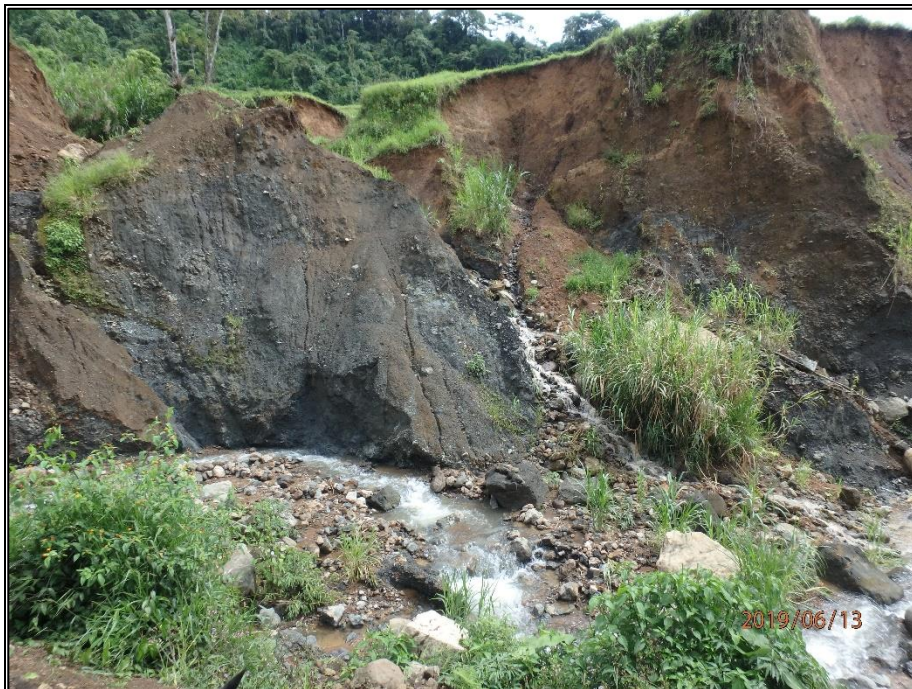
Fotografía A.1.6 Deslizamiento activo, está compuesto por material heterogéneo, se observan brechas inconsolidadas color gris verdoso y café claro. Coordenadas 596853.38E - 979303.47N.
