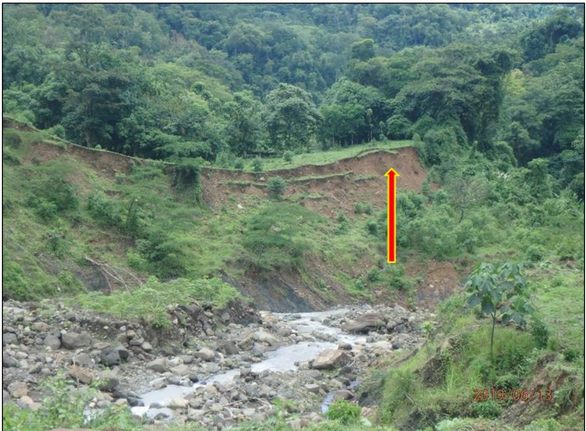
Fotografía A.1.22 Hacia la desembocadura de la quebrada Paraíso las laderas inestables presentan una rotación y un levantamiento de la superficie hacia aguas arriba. Coordenadas 598546.58E - 979189.61N.
