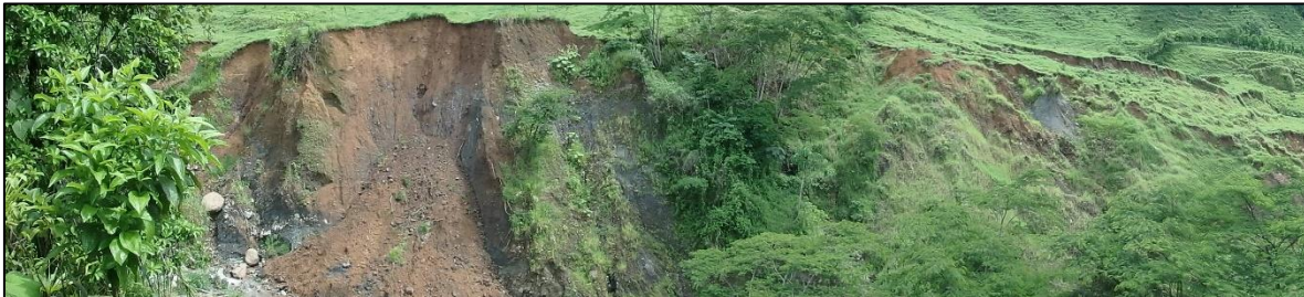
Fotografía A.1.5 Deslizamiento activo, límite superior - Norte, las quebradas y ríos producen un proceso de erosión del pie que desarrollan desprendimientos continuos de las márgenes. Coordenadas 597039.87E - 979353.64N.
