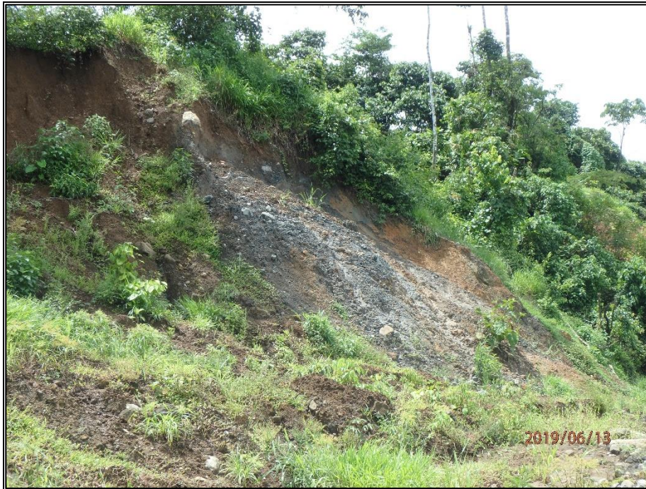
Fotografía A.1.13 Laderas inestables de la quebrada Paraíso, flujo de lodos con exceso de humedad. Coordenadas 597916.17E - 978831.69N.
