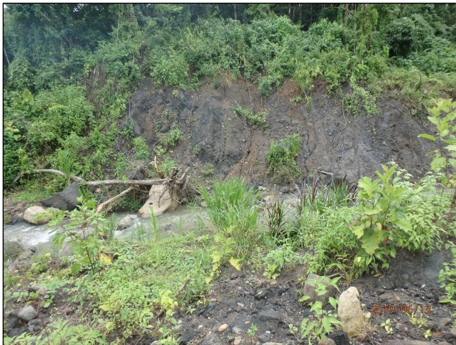
Fotografía A.4.2 Deslizamiento local que afecta el camino de Paraíso en el sector cercano a la torre de telefonía celular del ICE. Material es limo arenoso con bloques de roca. Coordenadas 595987.34E - 978715.86N.
