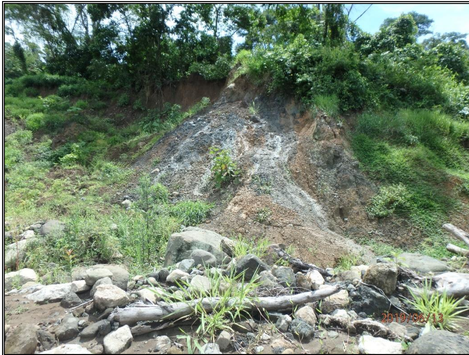
Fotografía A.1.14 Laderas inestables de la quebrada Paraíso, flujo de lodos con exceso de humedad. 597930.78E - 978809.15N.
