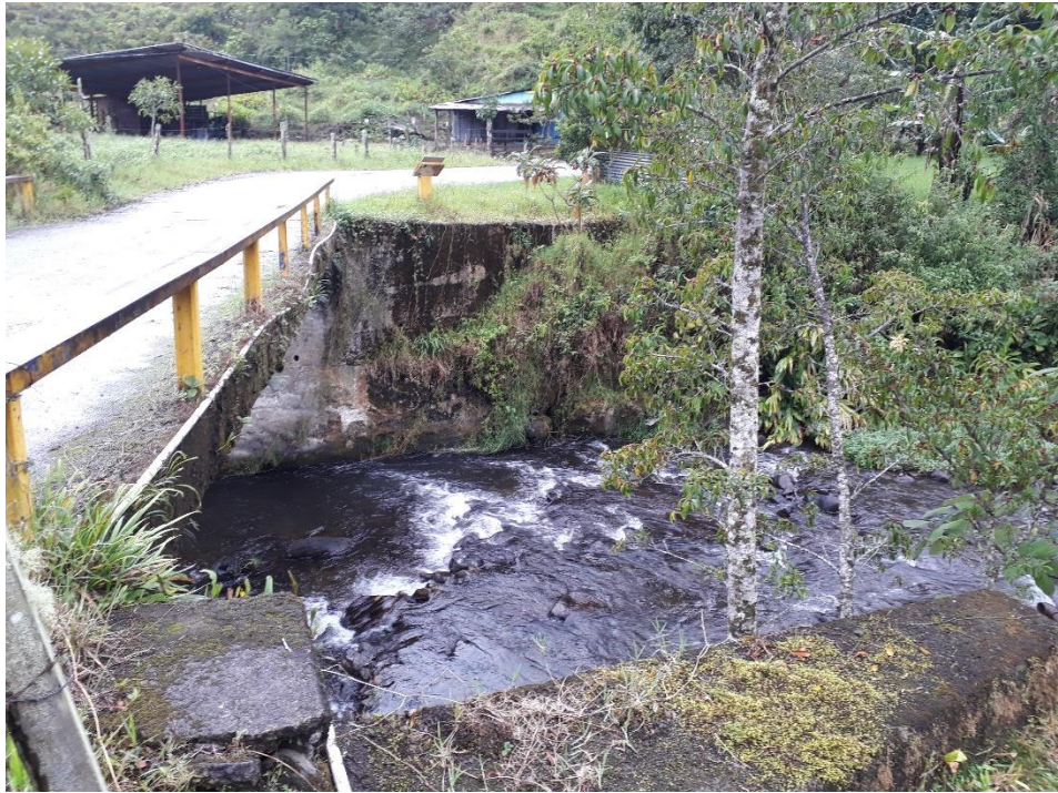
Fig. 54. Casas de habitación y puente sobre el río Toro camino a Río Segundo (mismo Fig. 53). Se observa el gálibo poco alto (luz entre el puente y las aguas), por lo que se vuelve un puente muy vulnerable. Se observan también los depósitos de flujos de escombros volcánico no muy antiguos en la margen del río.
