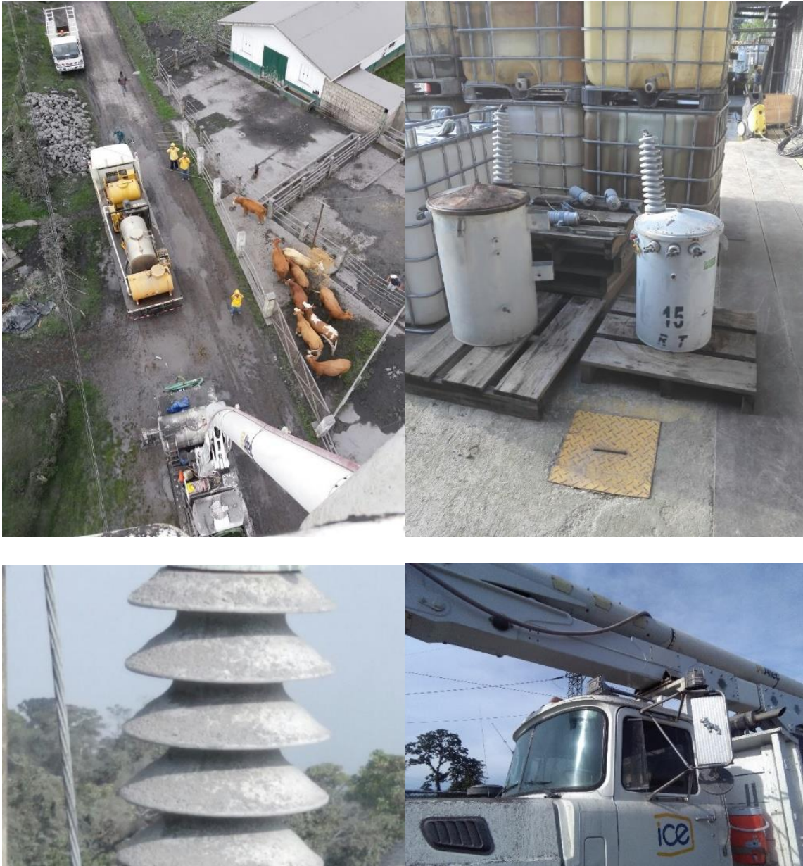
Fig. 4.11: Efectos de la caída de cenizas sobre aisladores y transformadores, que tuvieron que ser substituidos y limpiados por el personal del ICE en mayo del 2016 (cortesía de Claudio Paniagua).
