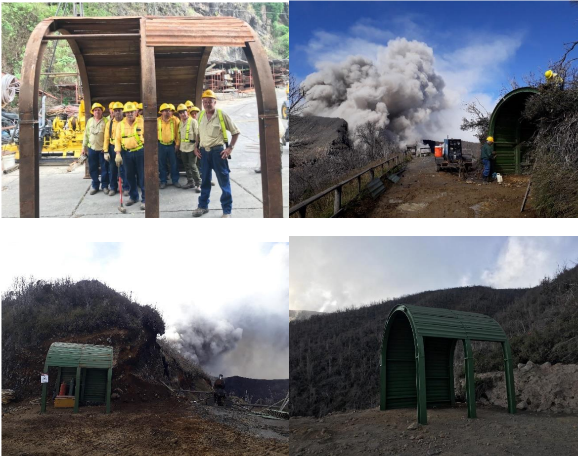
Fig. 4.18: Ejemplo de los siete refugios antibombas volcánicas, construidos en las instalaciones del ICE de la Garita, su proceso de instalación en el campo y acabados finales en el volcán Turrialba.
