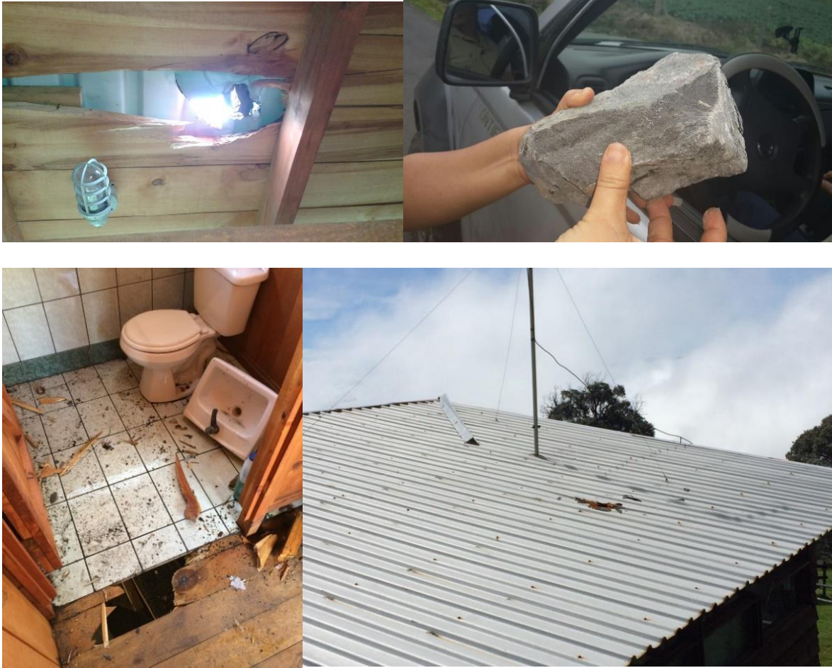
Fig. 4.16: Ejemplo de un proyectil balístico y sus efectos en la infraestructura (techo; servicio sanitario y piso) en el puesto de guardaparques a 745 m de distancia del cráter Activo, a raíz de la erupción del Turrialba del 29 de octubre del 2014 (fotografías Reina Sánchez). Se calculó que la velocidad final fue de unos 300 km/h y su duración de vuelo dilató unos 20 s.
